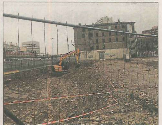
Sus aux gravats ! Le nouveau Montéty va s'étendre sur 20 000 mètres carrés restructurés. (Ph Franck Muller)
