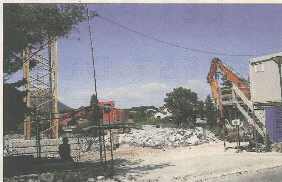
Allée du Bosquet, il ne reste rien de l'immeuble neuf.
