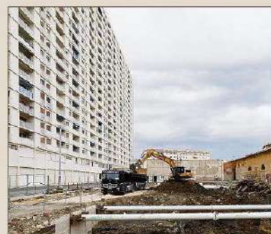
Après la fin de l'évacuation des terres du chantier de terrassement, l'entreprise va achever les fondations dans le courant de ce mois d'octobre. (Photo Dominique Leriche)
