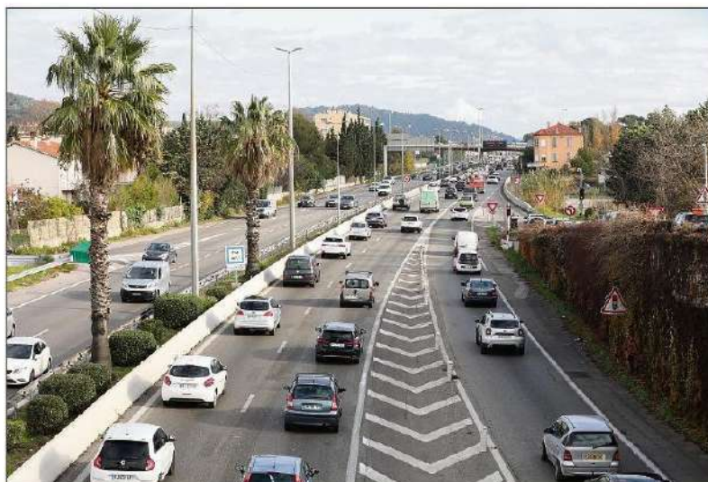
D'ici 2025, l'A57 doit être portée à deux fois trois voies de la sortie du tunnel de Toulon jusqu'à l'échangeur « pierre ronde » qui permet de bifurquer vers Hyères. Le chantier doit permettre de désengorger un axe emprunté par 110 000 automobilistes par jour. (Photos Luc Boutria et doc. V-m.)
